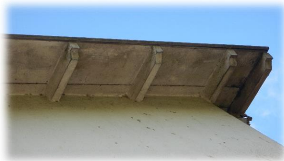
Figure 10: Illustration de l'absence d'accès aux combles via la toiture
