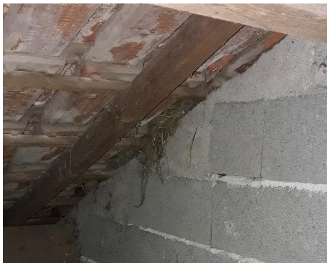
Figure 6 : Nid de Moineau domestique au sein des combles et accessible par un écart entre les tuiles depuis l'extérieur
